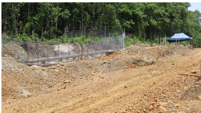
パイプライン破損地点近くの状況（トウティ郡／2026年2月）
